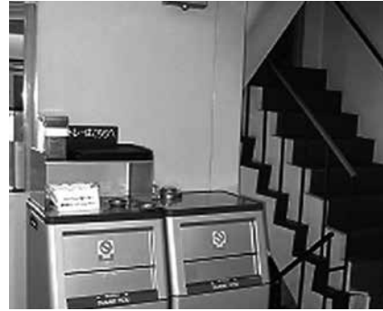
建物構造 2 防火シャッター下に物品の存置
