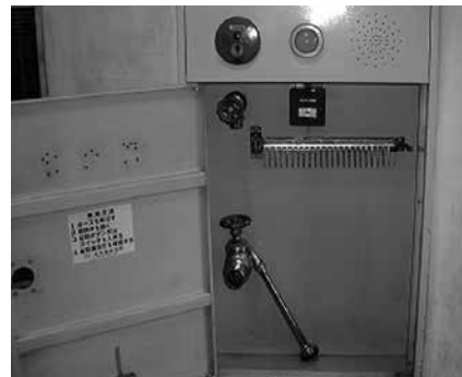
消火設備の管理 2 屋内消火栓設備箱にホースがない
