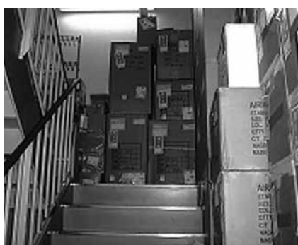
避難管理 2 避難階段に物件存置
