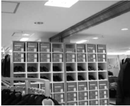
建物構造 1 防火シャッター下に物品の存置
